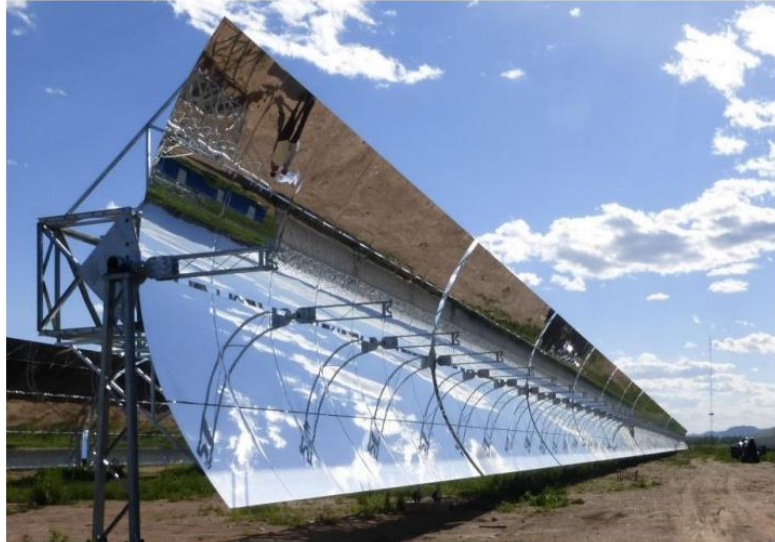
图表 2 槽式光热电站镜场集热器
